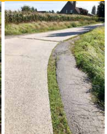
Houtlandstraat, Assenede Ook hier is het wegdek er slecht aan toe.
