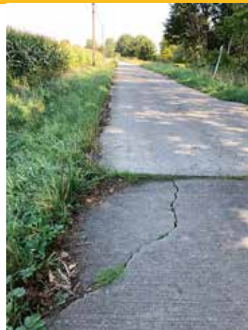
Garenhoek, Assenede Het wegdek verkeert in erbarmelijke staat.
